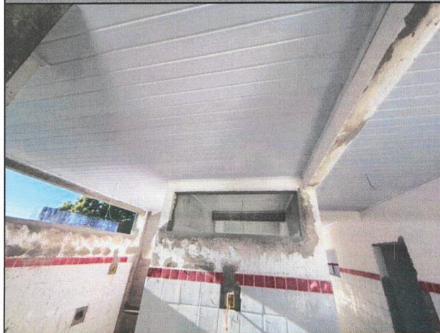
DESCRIÇÃO FORRO; INSTALAÇÃO ELÉTRICA
