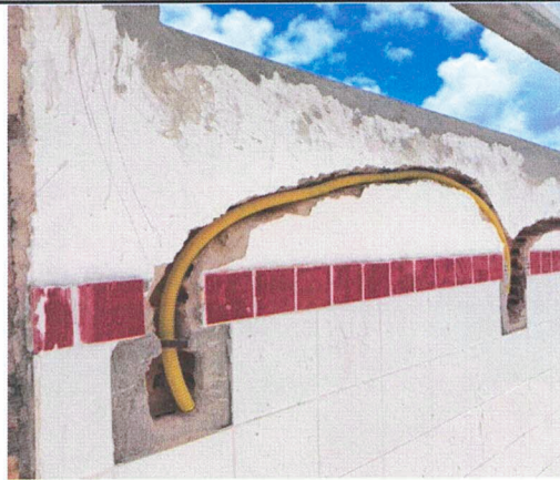
DESCRIÇÃO INSTALAÇÃO ELÉTRICA
