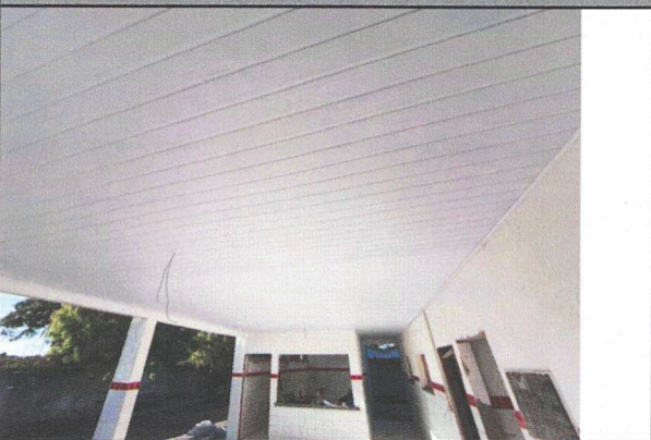
DESCRIÇÃO FORRO; INSTALAÇÃO ELÉTRICA
