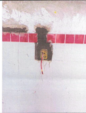
DESCRIÇÃO INSTALAÇÃO ELÉTRICA
