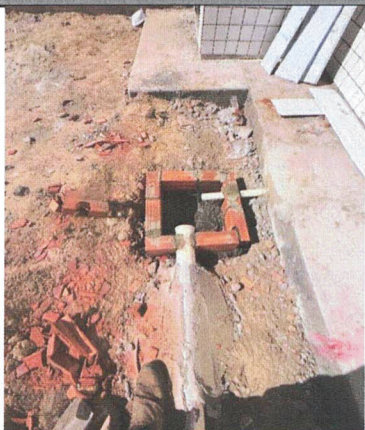
DESCRIÇÃO CAIXA DE PASSAGEM
